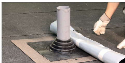
4. Påbörja intäckningen nedifrån med en kappan av E-Lit LA. Arbeta alltid nedifrån takfallets riktning och upp.
