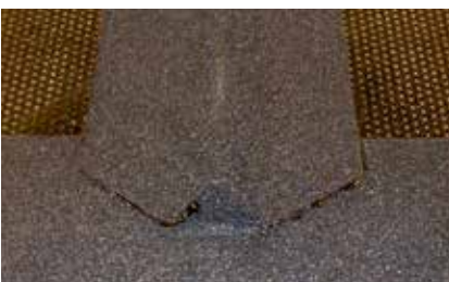
4. Svetsa remsan mot underlaget och listens avslut. Var extra noga med att använda rätt mängd värme för att undvika stora utrinningar av asfalt.
